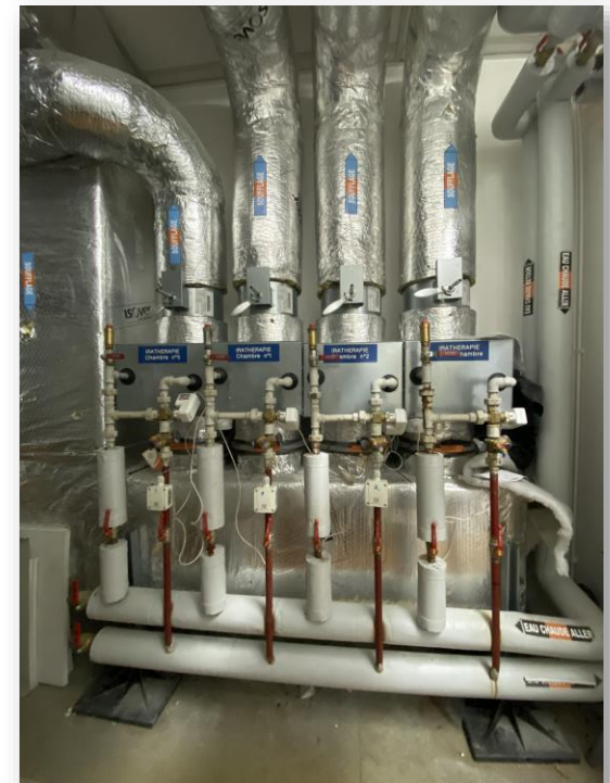
Centrale de ventilation
