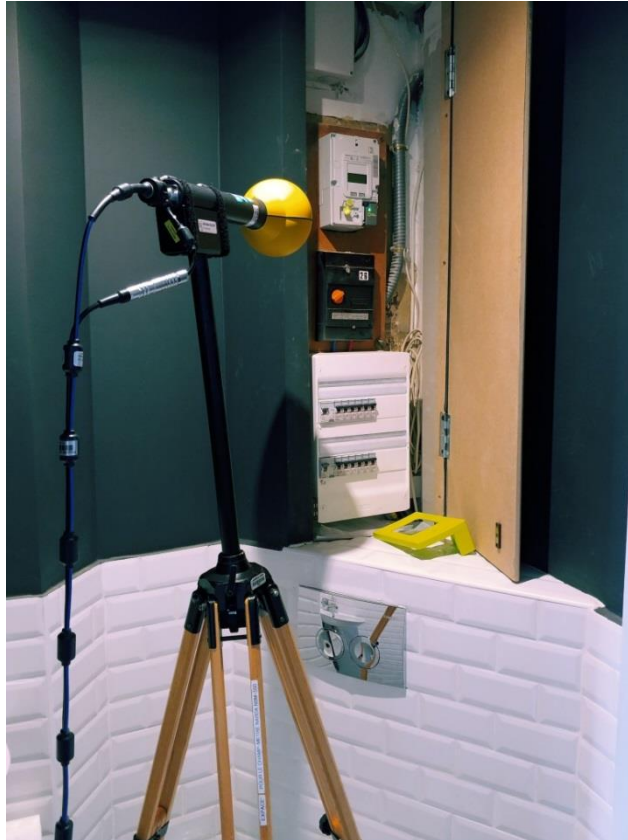
Figure 2 : installation de la sonde de mesure à 50cm de l'ERL (clé Atome de Direct Energie)
