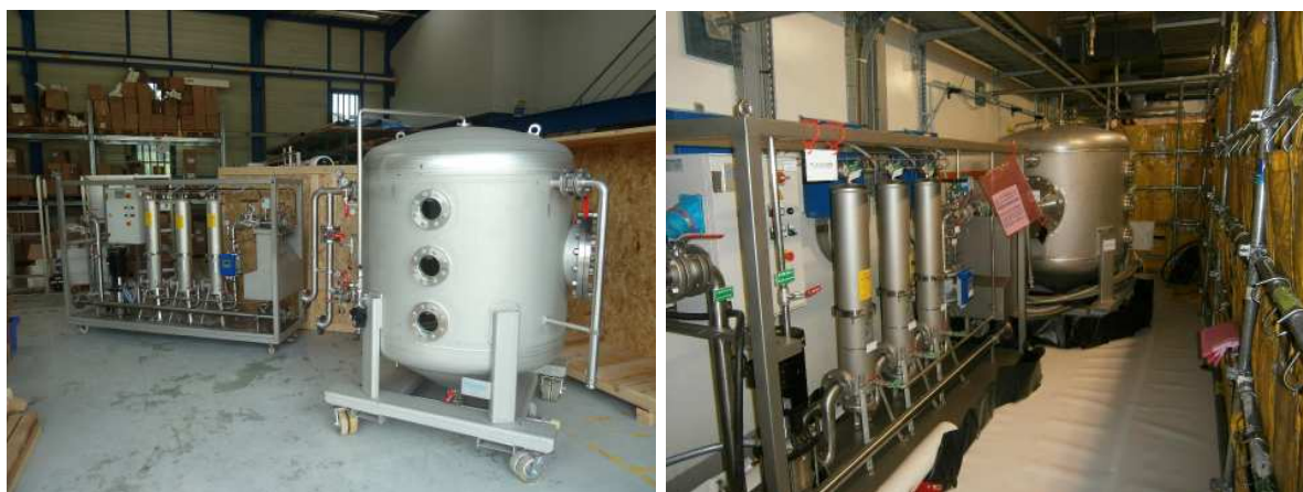
Figure 1. Unités de traitement mobiles (skids) TEU
