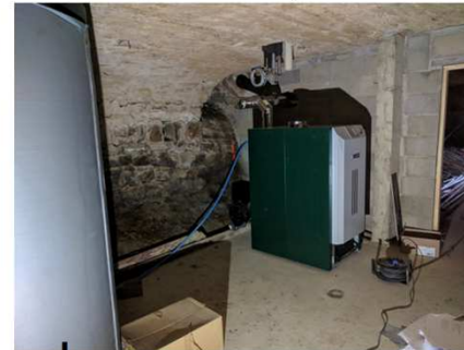
Janvier 2021 Chaudière, cheminée et plomberie
