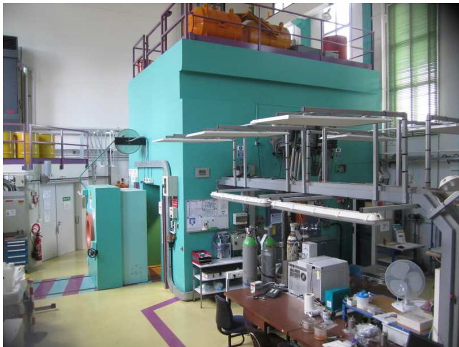
Figure 1 : Installation IRMA (cellule d'irradiation et hall d'expérimentation)
