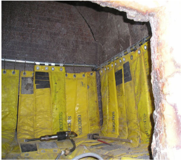
A l'intérieur du four panneaux de plomb
