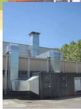
Vue de la ventilation de substitution
